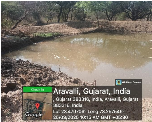
Mini percolation tank
